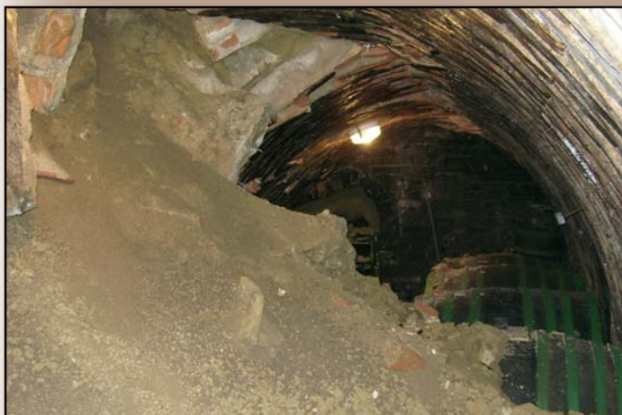
Havárie sklepu manželů Bukovkých
