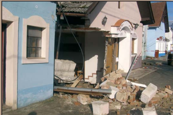
Havárie v areálu sklepů pod Kraví horou
