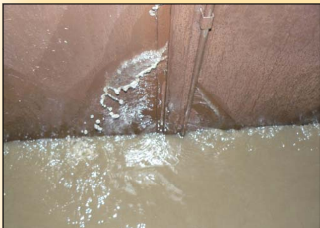
Voda protéká škvírami do garáže
