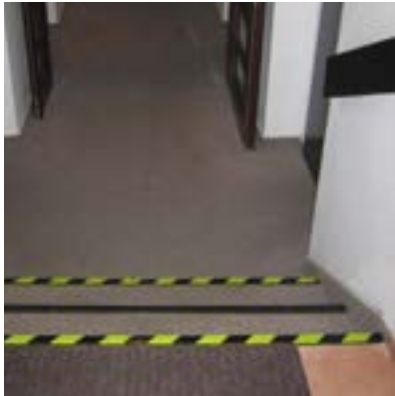
bariéra v podobě nejednotné úrovně podlahy chodby brání pohybu na vozíku
