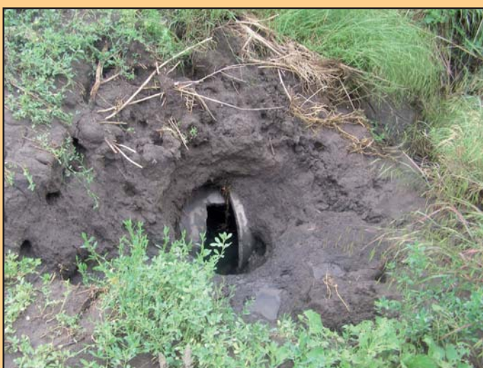
Propadená kanalizace na Zápovědi
