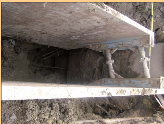
Havárie kanalizace před Petráskovým
