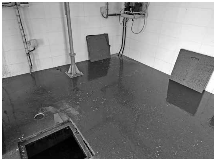
Následek ucpaného čerpadla – vyplavená místnost v technologické části budovy ČOV, foto F. Petrásek
